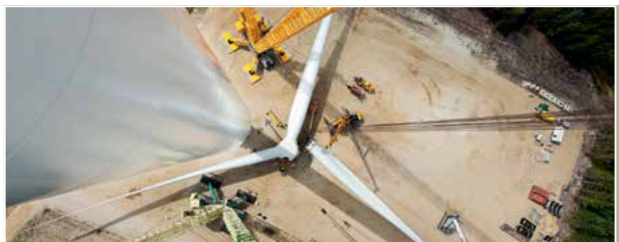
Der Rotor wird im Testcenter in Østerild am Bodn montiert. In dem IntegralBlade-Verfahren werden die Rotorblätter in einem Guss und ohne Klebestellen produziert.
