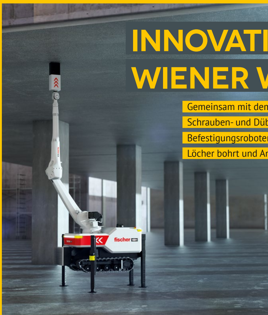
Nächste Stufe der Automatisierung am Bau: Vollautomatisches Bohren, Bohrlochreinigen, Markieren und Befestigen an Decken, an Wänden und in Böden durch den Einsatz des fischer BauBot.
